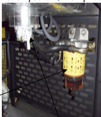
Электростанция открытого типа
